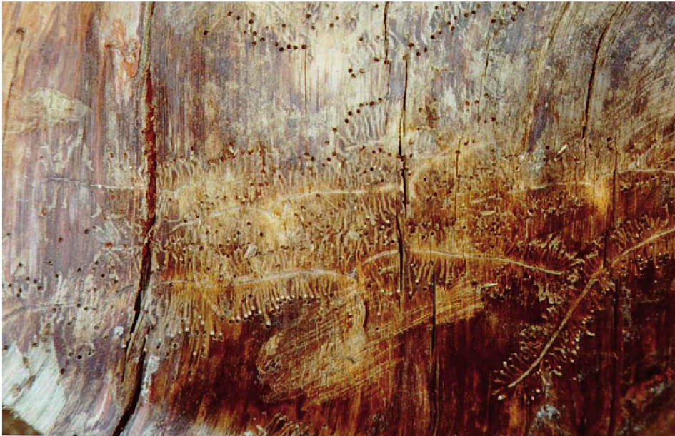
Figura 2.121. Madera con picaduras
