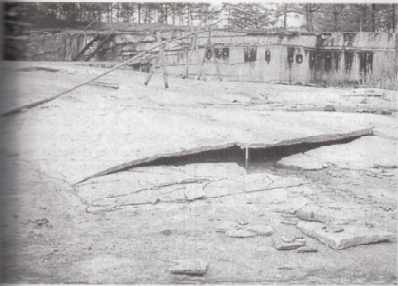
FIGURA 6.8 Juntas laminares formadas por expansión en el granito de monte Airy, Carolina del Norte. (Foto cortesía de W. D. Lowry.)
